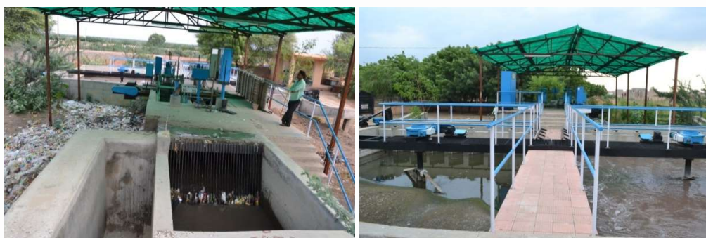
सीवरेज ट्रीटमेंट प्लांट, नान्दड़ी
